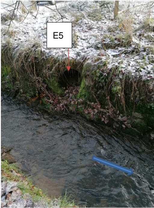
Abbildung 10: Einleitstelle E5, keine Grobstoffe erkennbar
