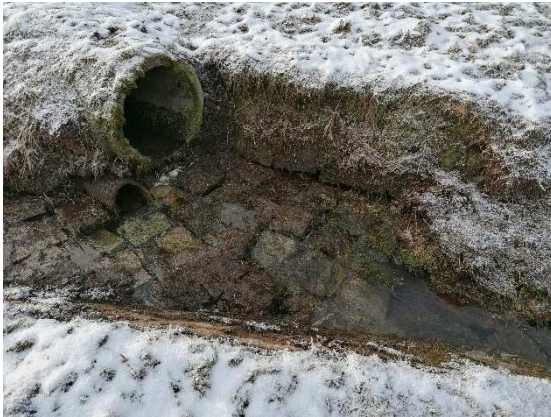
Abbildung 1: Einleitungsstelle RÜB 1 mit Wasserbaupflaster befestigt
