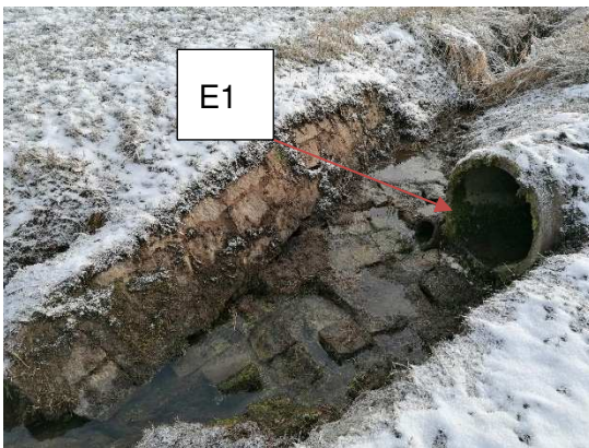
Abbildung 2: Einleitungsstelle E1 – leicht verschobener Wasserbaupflaster
