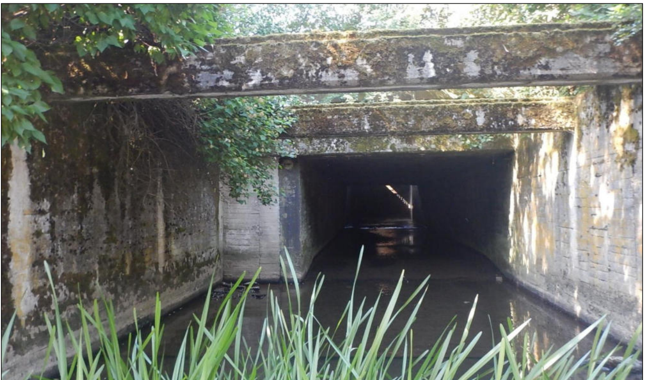
Abb. 72: Göstra bei F-km 0,59 – Überbauter Bachabschnitt mit senkrechten Seitenwänden und betonierter Gewässersohle; Blick flussaufwärts
