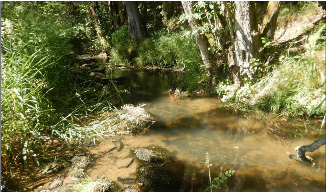
Abb. 66: Göstra bei F-km 1,31 – Freigespülte Baumwurzeln (linkes Ufer); Blick flussaufwärts
